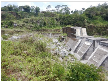
Gendol川上流域のスリット砂防堰堤
